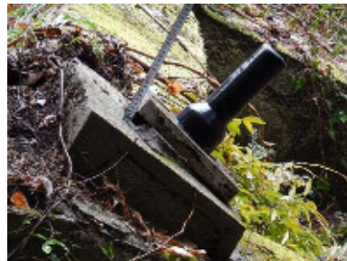
アンカー頭部の浮き
