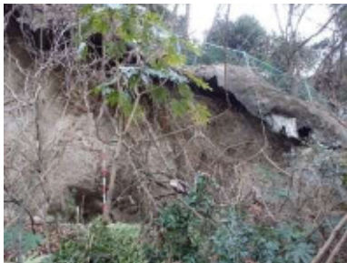
モルタル吹付の剥落
