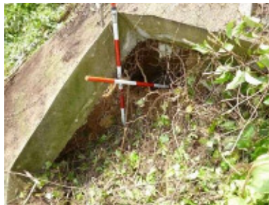
法枠工背面土砂の流出
