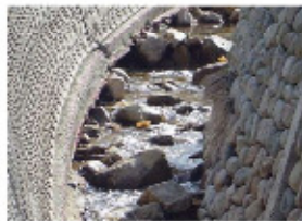
護岸工基礎部の洗掘
