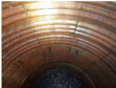
集水井鋼材の腐食
