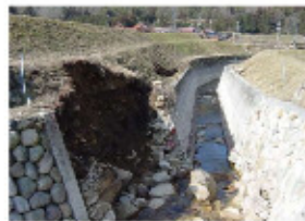
護岸工の損傷
