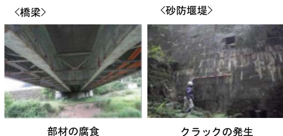
【腐食・損傷の状況】
