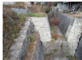
床固工のひび割れ
