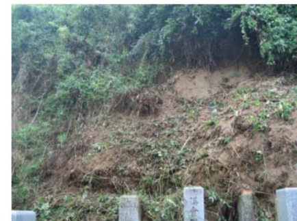
斜面崩壊・被災状況（H30年7月）
