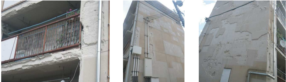
写真 老朽化による傷みが現われた県営住宅
