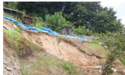
斜面崩壊・被災状況（H30年7月）
