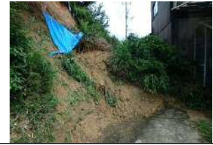
斜面崩壊・被災状況（H30年7月）
