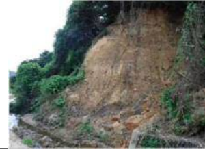
斜面崩壊・被災状況（H30年7月）
