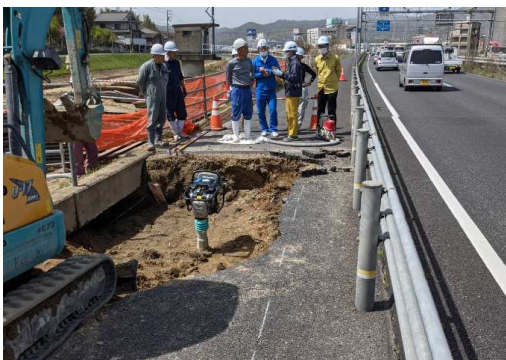
一般国道2号の歩道陥没状況 （令和3年3月31日（水））
