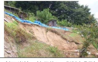
斜面崩壊・被災状況（H30年7月）
