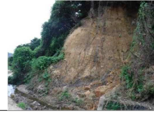
斜面崩壊・被災状況（H30年7月）
