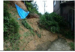
斜面崩壊・被災状況（H30年7月）
