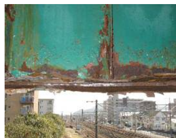
主桁の塗装劣化
