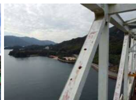
上部工の塗装劣化
