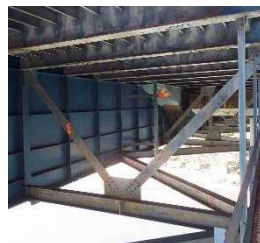
上部工の塗装劣化
