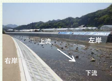
一級河川太田川水系 三篠川 災害復旧助成事業 (広島市安佐北区白木町地内)
