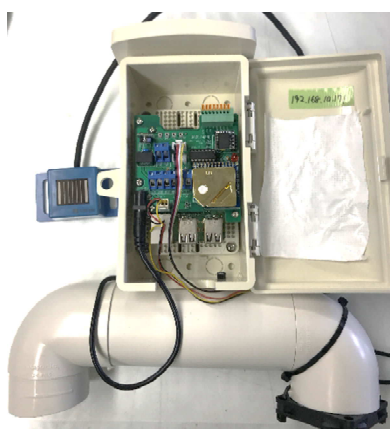
製作予定の計測ノード
