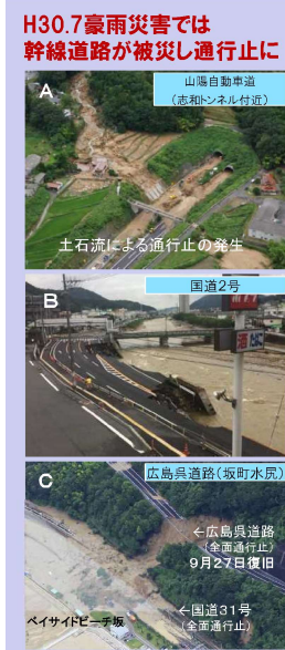
H30年7月豪雨では幹線道路が被災し通行止に
