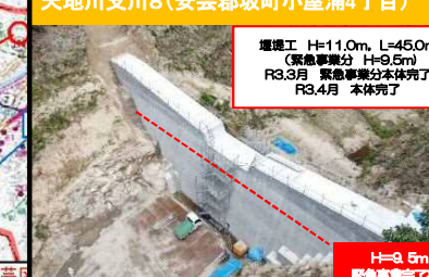
堰堤工 H=11.0m, L=45.0m (緊急事業分 H=9.5m) R3.3月 緊急事業分本体完了 R3.4月 本体完了
