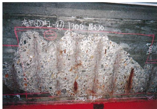
コンクリートの剥離
