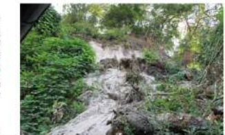
斜面崩壊・被災状況（H30年7月）
