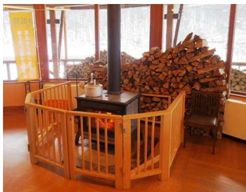
【設置した薪ストーブ（広島市）】
