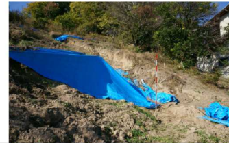
斜面崩壊・被災状況(令和2年7月)
