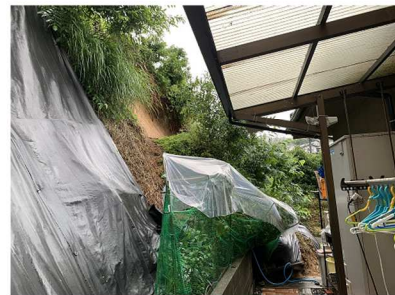
斜面崩壊・被災状況(令和2年7月)
