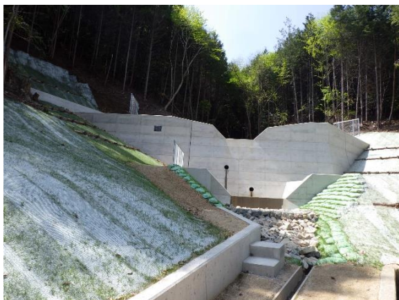
県：治山激甚災害対策特別緊急事業 岩鼻地区 (安佐北区白木町)
