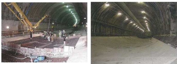
インバートコンクリート
