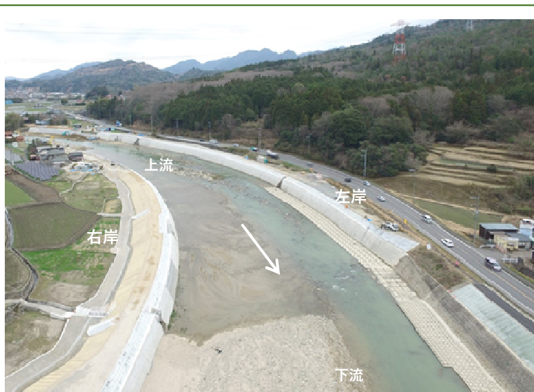
一級河川太田川水系 三篠川 災害復旧助成事業 (広島市安佐北区白木町地内)
