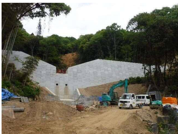
荻之尾川隣 災害関連緊急砂防工事 (福山市, 令和3年3月末時点)
