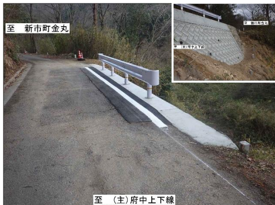
令和2年災 第246号 (一)金丸市場線 道路災害復旧工事 (府中市木野山町 令和4年2月完成)
