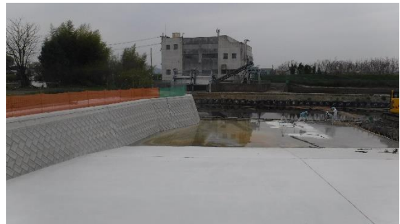
古市排水ポンプ場
