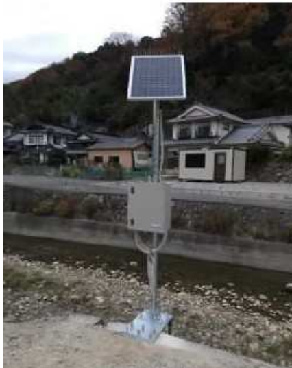
簡易型監視用カメラ 【設置例】
