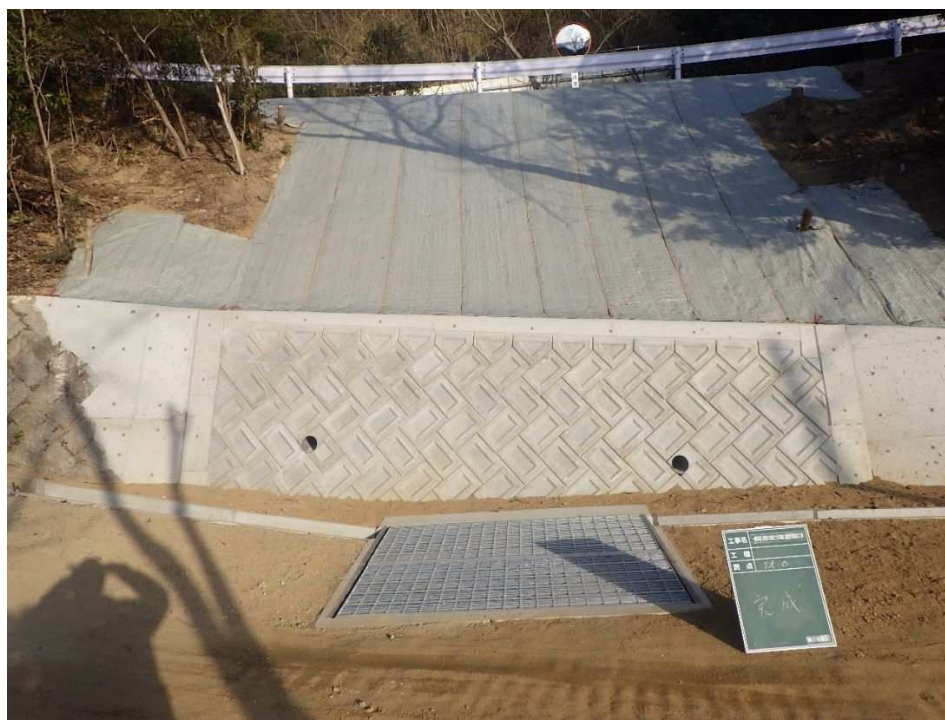
令和 3 年発生災害 一般県道 倉橋大向釣士田港線 道路災害復旧工事 (呉市倉橋町)
