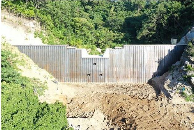
県：砂防激甚災害対策特別緊急事業 亀石川 2 (坂町水尻)
