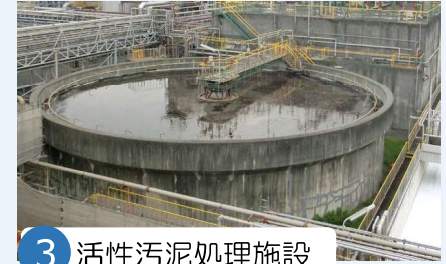
2 活性汚泥処理施設
