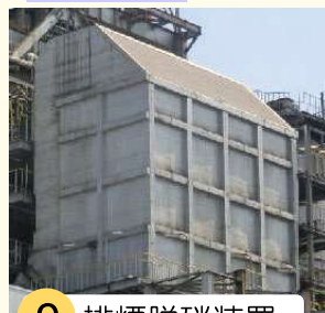
9 排煙脱硝装置
