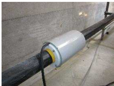
写真-1 設置状況
