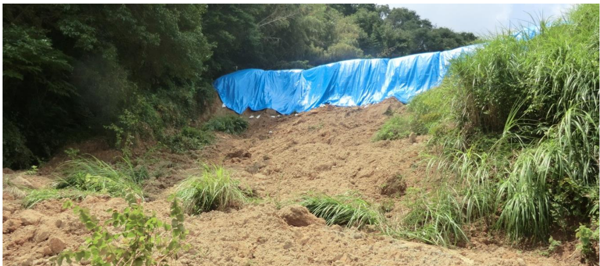
写真 I - 6 越流・浸食により損壊したため池
