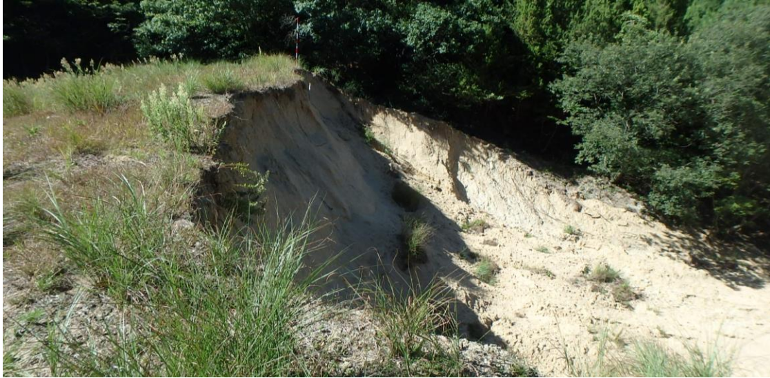
写真 I - 5 すべり破壊が発生し損壊したため池
