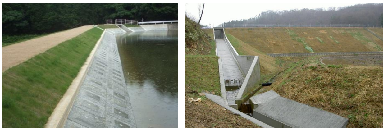
写真Ⅳ-3 改修工事による補強対策（左：堤体の改修，右：洪水吐の改修）
