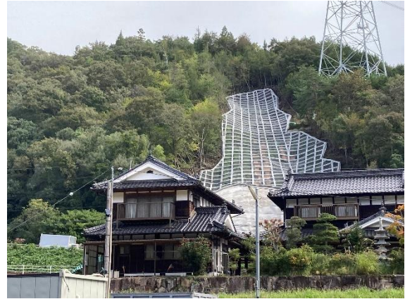
県：治山激甚災害対策特別緊急事業 平山地区 (東広島市福富町)
