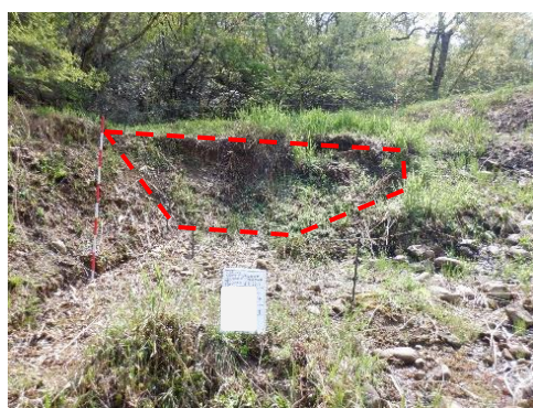
劣化診断：健全度が低いCとなった箇所 堤体の陥没、水漏れが見られる
