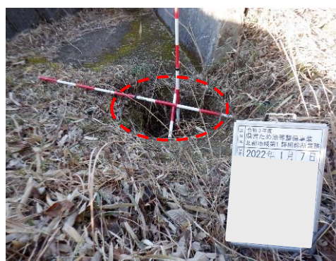
豪雨診断：健全度が低いCとなった箇所 洪水吐の破損が見られる
