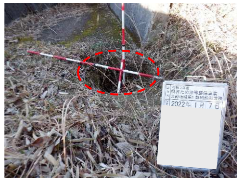
豪雨診断：健全度が低いCとなった箇所 洪水吐の破損が見られる
