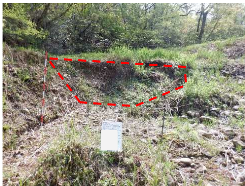
劣化診断：健全度が低いCとなった箇所 堤体の陥没、水漏れが見られる
