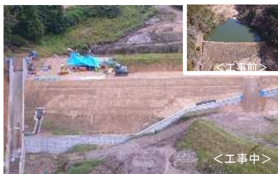
ため池の補強工事状況(庄原市) (堤の再構築と水路の拡張)
