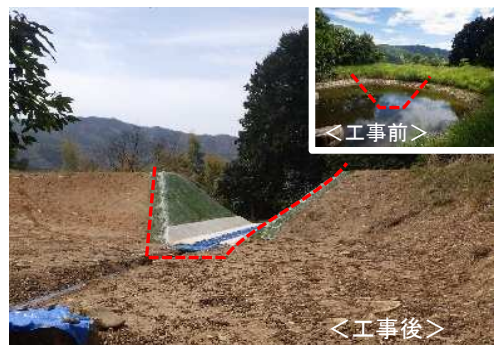
ため池の廃止工事状況(安芸高田市) (堤体を開削し水路を設置)
