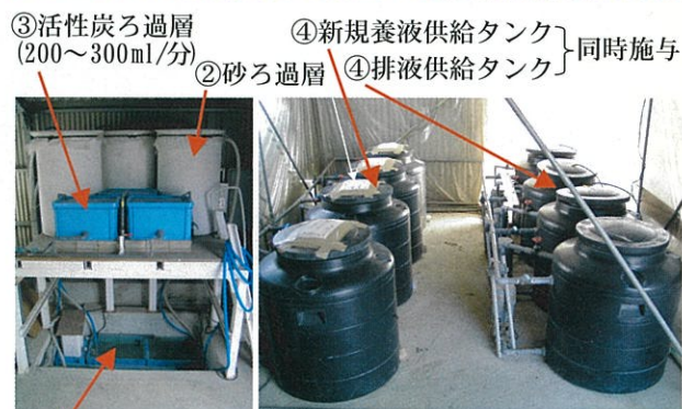
①排液貯留槽
