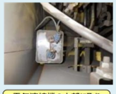
電気溶接機の内部に取り付けられた低圧コンデンサー
