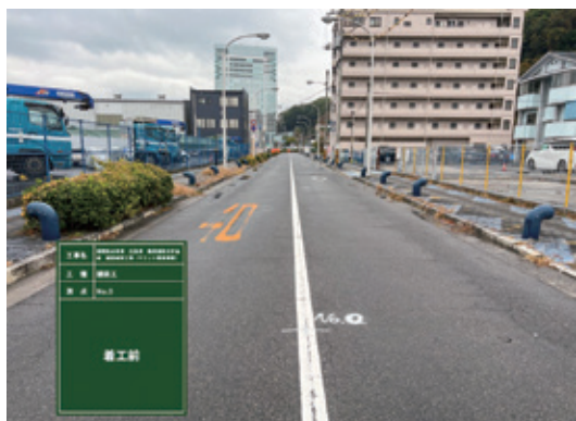
舗装補修前（臨港道路元宇品線）
