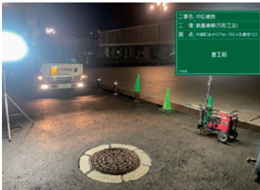
マンホール補修前 (平和記念公園)
