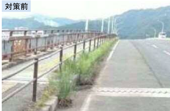
路肩の堆積土からの草の繁茂状況
