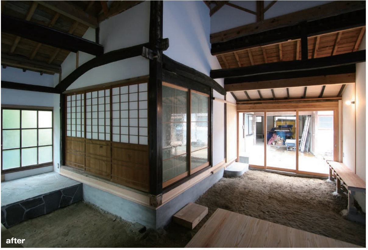
既存の床組みを取り払うと当時の三和土が表れた。居間には既存の腰板付障子を転用している。
