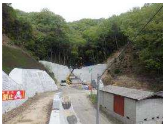
観音谷川 砂防激甚災害対策特別緊急工事 (府中市広谷町 施工中)
