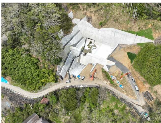
宮ノ間川 砂防激甚災害対策特別緊急工事 (府中市河佐町 施工中)
