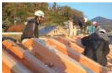
地域の材と技術でつくり、守り育てる住まい／地域の木材産業と大工・工務店が連携することで実現する、広島の森を身近に感じ、愛着の深まる家づくり。
