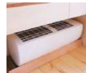
LDに設置された暖房用のエアコンは床下に温風を吹込み、家全体を暖房。
