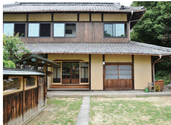
劣化が激しかった2階の外壁を焼杉板に張替え、ダイニングの窓には木枠の網戸を造作した。
