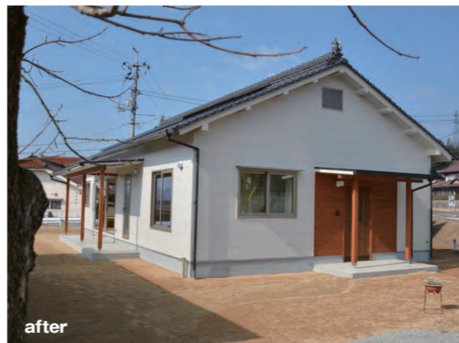
劣化したモルタル外壁は撤去、軽量のサイディング+杉板を張り清々しい印象にした。
