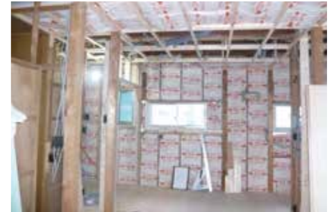
外周面は取替、天井には新しく断熱材を敷き詰め、床下の断熱材を取替合板で補強。窓を複層ガラスに交換。LDKを魔法瓶の様に包み込んだ。
