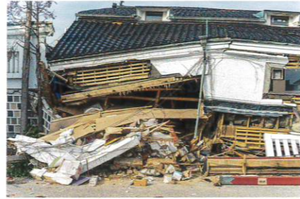
地震による被害例 (能登半島地震)
