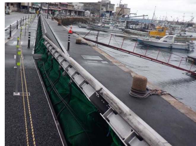
起伏式ゲート 起動中
