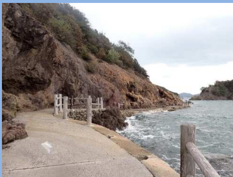
立入防止柵流失箇所
