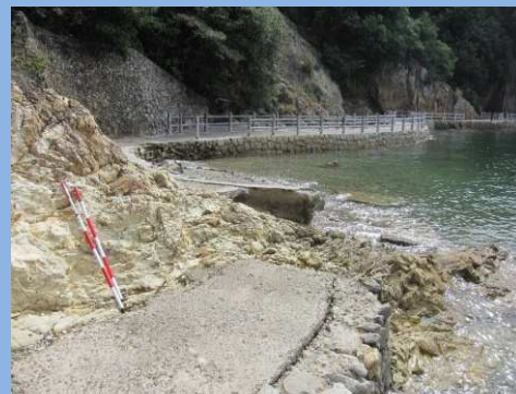
路盤流出箇所
