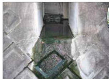
1990年代 浄化槽設置地域の側溝の例 (きれいな水が流れています)
