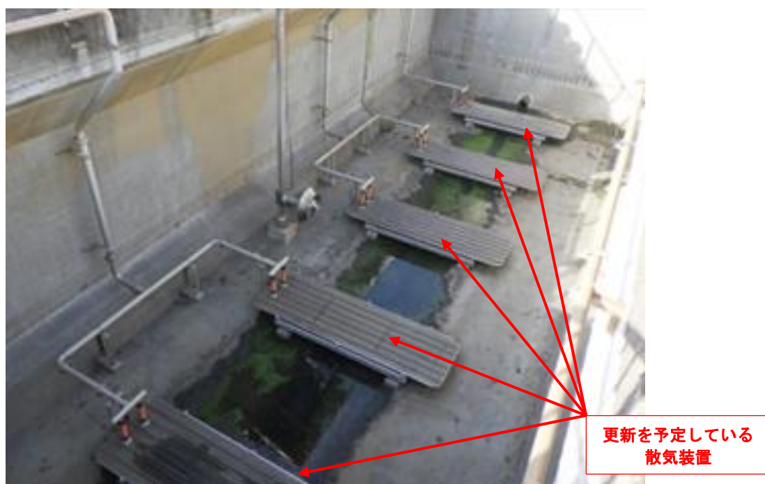
既設機器設置状況（反応タンク）
