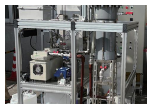
CO 2 吸収装置
