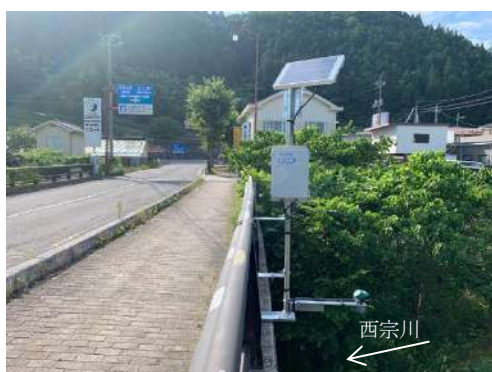
危機管理型水位計（西宗川・北広島町）
