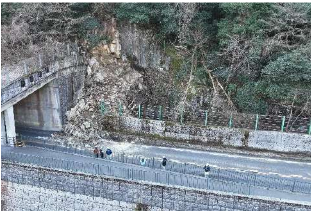
落石発生状況
