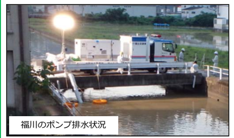
④排水ポンプ車等に関する連絡体制強化
