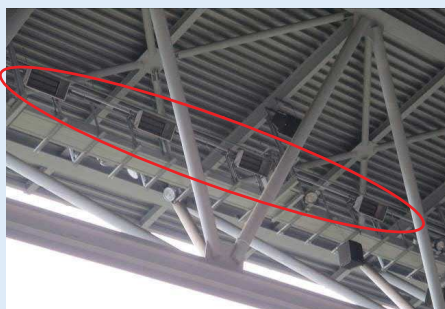
屋根裏のヒーター 冬季の観戦での寒さ対策として、屋根裏にはヒーターが設けられており、観戦環境の向上に寄与。
