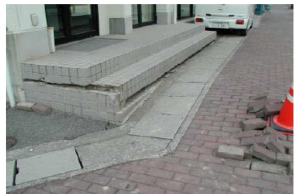
H13 芸予地震による液状化（広島港海岸）
