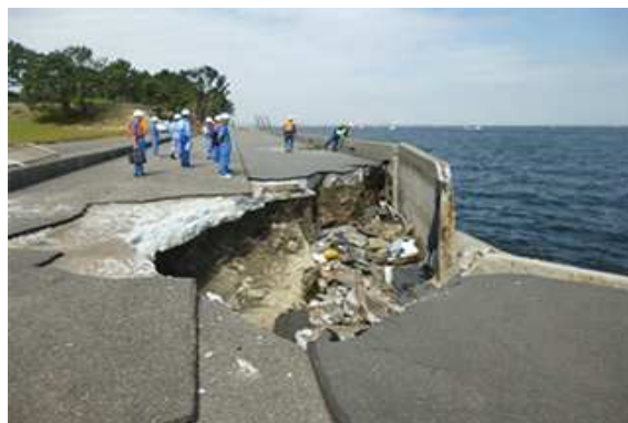
令和元年房総半島台風により被災した護岸 (出典:国土交通省関東地方整備局)
